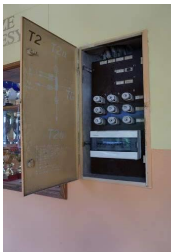
ROZDZIELNIA WYDZIAŁOWA T2
